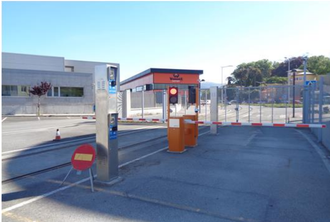
Sistema de control de accesos
